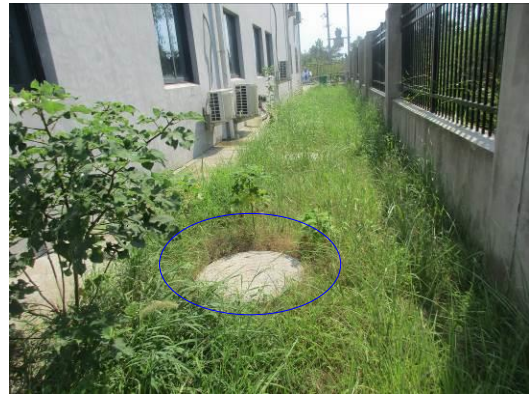
光伏电站区设置的污水收集系统
