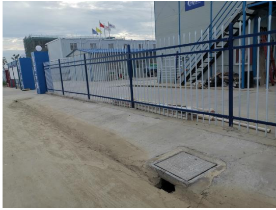
施工营地雨水井
