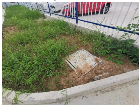
施工营地雨水井
